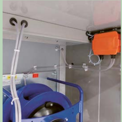
Afbeelding 5.6 Luchtdebietmeting met drukverschilmeting op de ventilatormond
